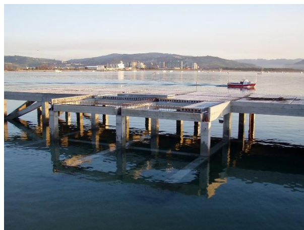
Figura.- Placas alveolares en ambiente marino (corrosión por cloruros)
