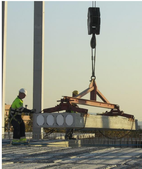
Figuras.- Montaje de placa alveolar: se suelta la cadena de seguridad antes de colocar en su ubicación definitiva
